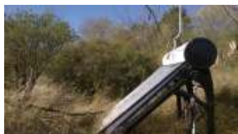
3 ENERGÍA: agua caliente mediante termostaque solar. Ingreso de luz natural: ahorro de energía.
